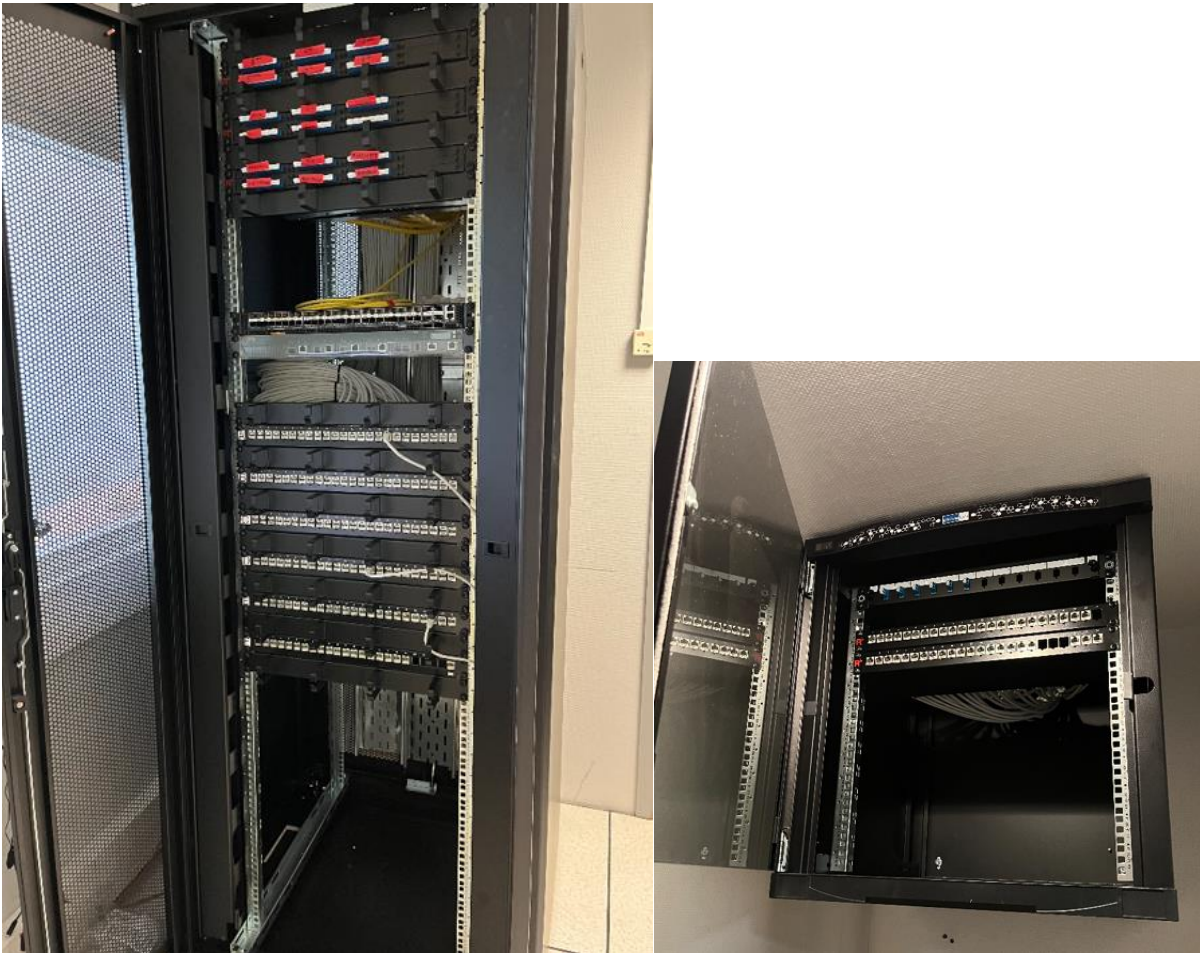
2 – Nouveaux baies réseaux
